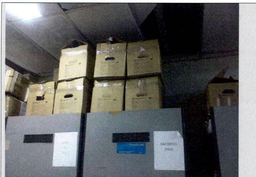
Foto. Deterioro del techo del depósito de archivo.
