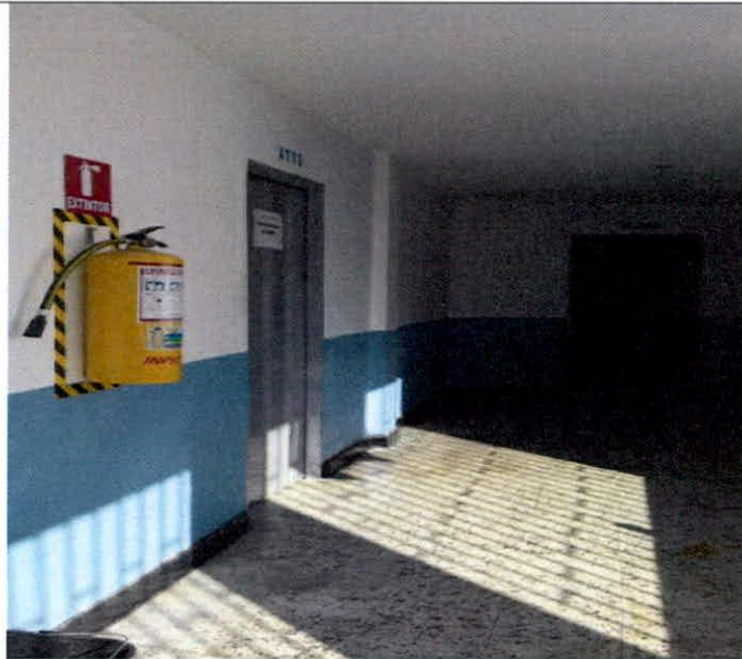
Extintor oficinas segundo piso
